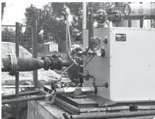
Рис. 6.2. Город Красный Сулин, центральная городская котельная мощностью 19,3 МВт. Монтаж испарительно-смесительной установки Metan-3-2-760 производства завода «Газ-Сервис» в качестве источника резервного газоснабжения
